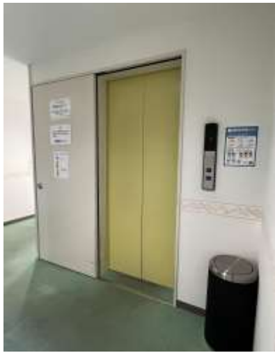
▽エレベーター
